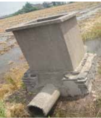
图二 田间放水窰井
